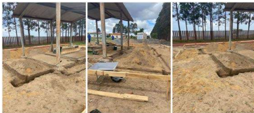
Início da obra de adequação do abrigo de Resíduos de Serviços de Saúde, no Campus JK
